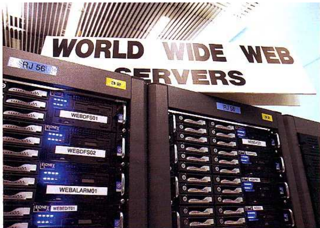
Rechenzentrum (in Genf): Die Internet-Seiten sind die Katakomben der Neuzeit
